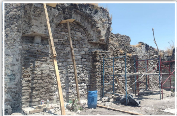
Figura 22. Se observan los mechinales, el hueco entre la pilastra y el arco.
