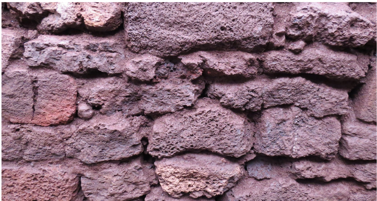
Fig. 13. Piedras carcomidas de la pared del templo interior de la Subestructura. Fotografía: Georgia Bravo Lopez.
