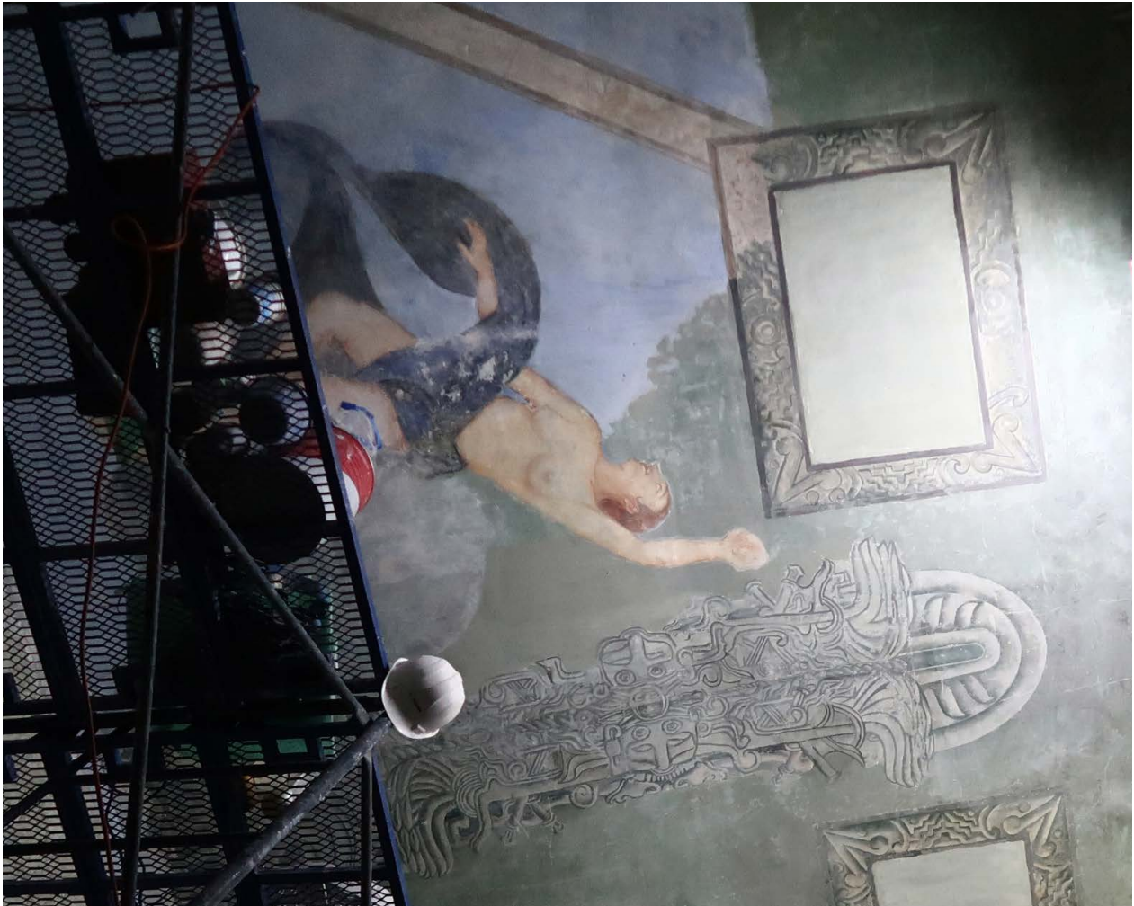
Bóveda de sala 8 en proceso de restauración. Fotografía: Mitzi de Lara Duarte, 2021.
