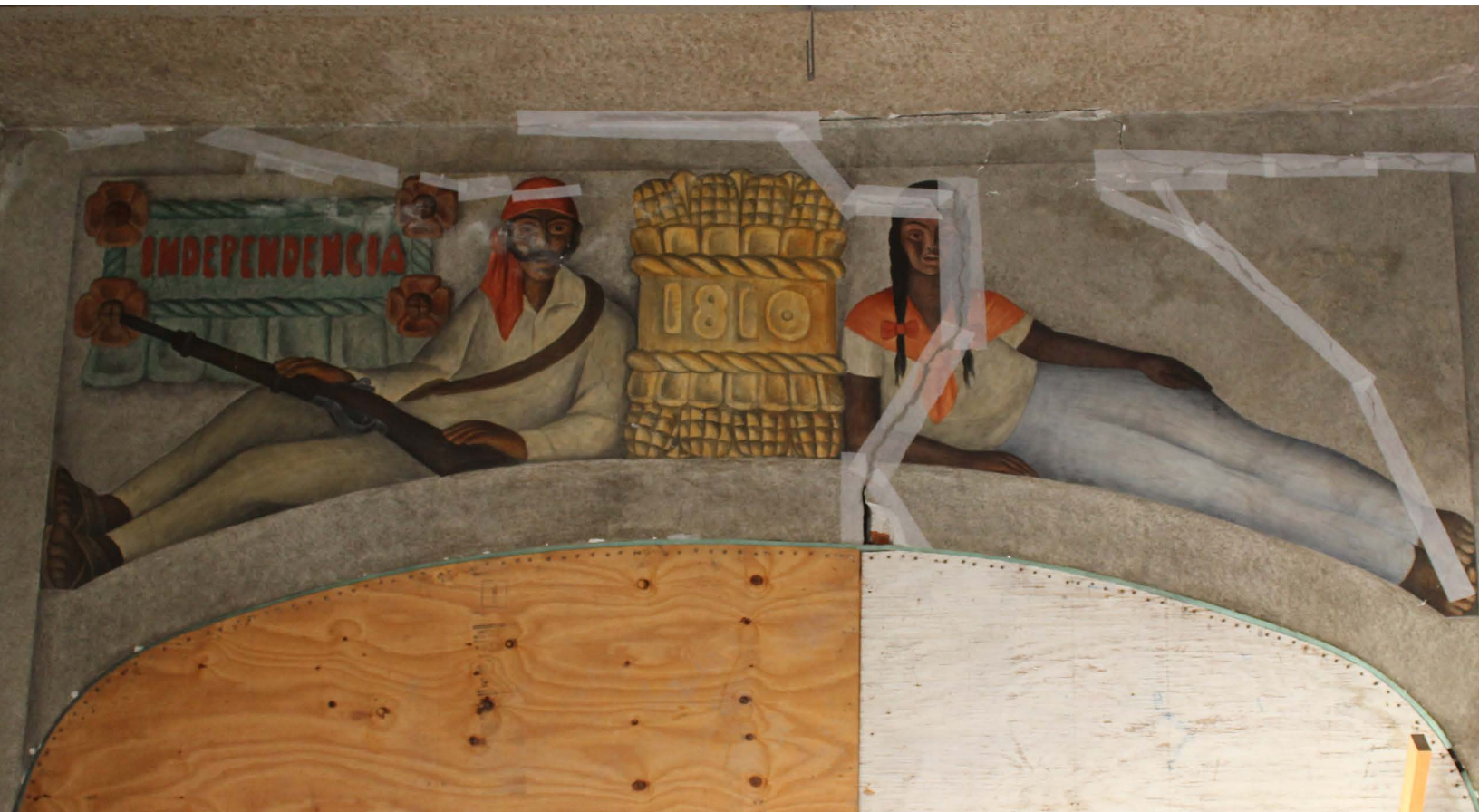
Lado norte del arco antes del desprendimiento de la pintura mural. Fotografía: Denise Charua Ayala.
