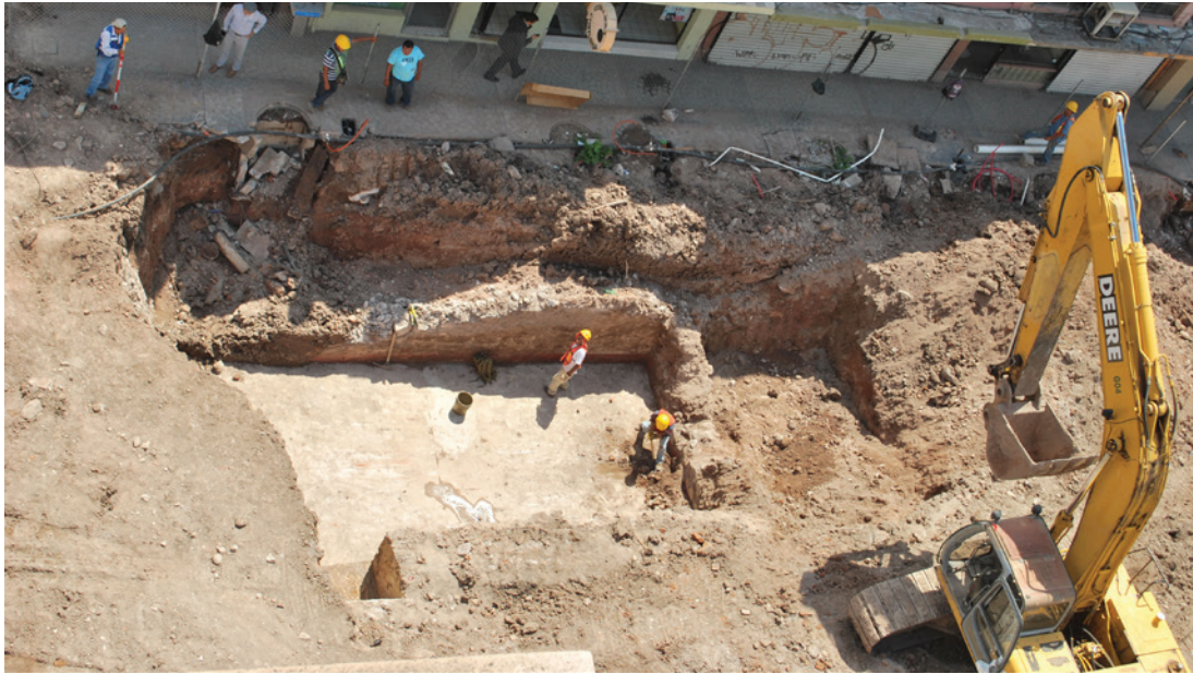
Excavación en la avenida Independencia, muestra los sótanos de casas construidas durante la segunda mitad del siglo XIX. Chihuahua, 2013. Fotografía: Alberto Peña.
