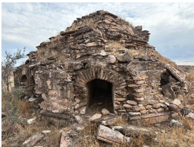
Inminente colapso. Guadalupe de Bagües, municipio de Coronado, Chihuahua. 2026. Fotografía: Luis G. Prieto Ramírez.
